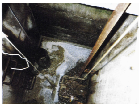
Station de relevage avant traitement
